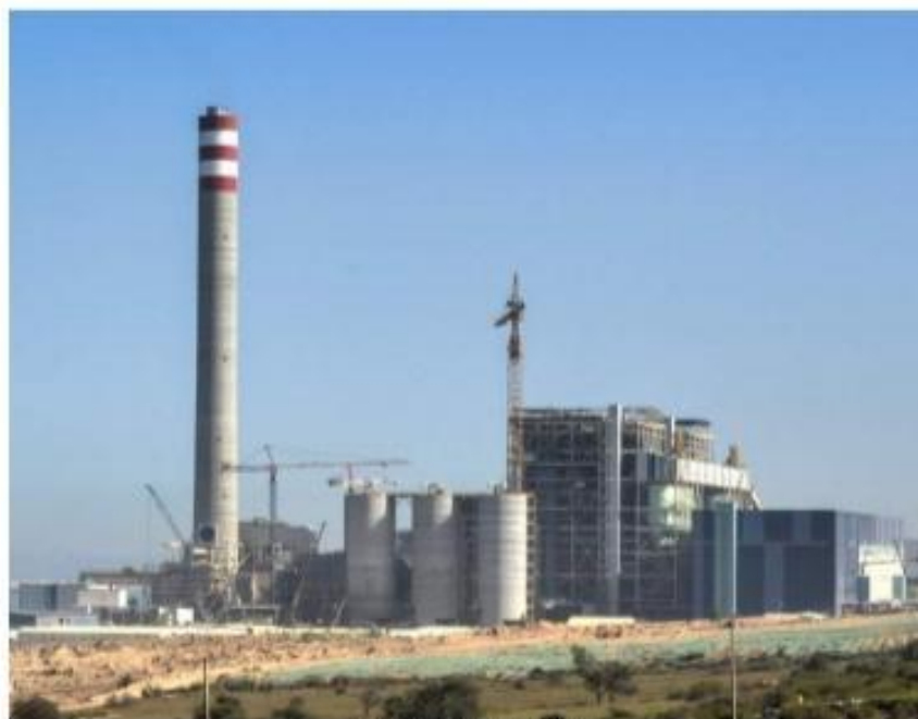
La centrale thermique de Safi
