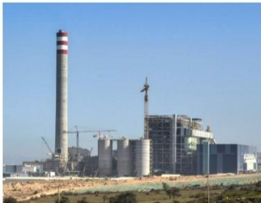
La centrale thermique de Safi
